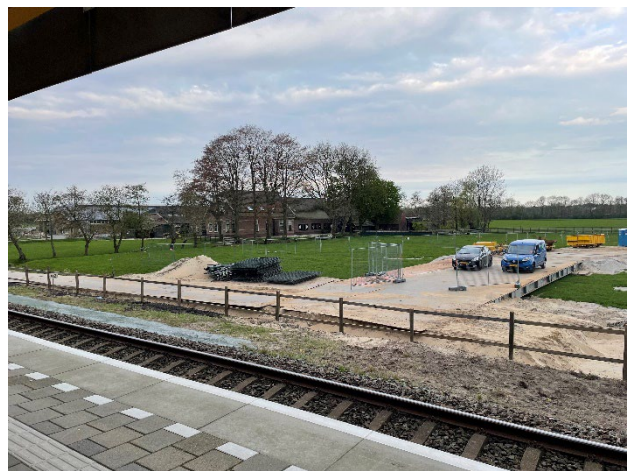
Bij boerderij Van Vliet geen lammetjes in de wei, maar een tijdelijke weg om de treinstellen af te kunnen voeren
